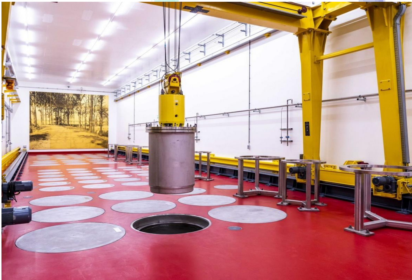
COVRA kõrgaktiivsete jäätmete vaheladustamise rajatis
